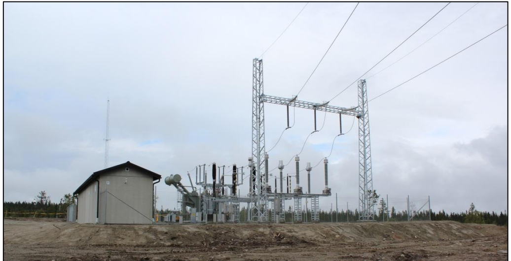
Kuva 12. Esimerkki 64 MVA sähköasemasta.
