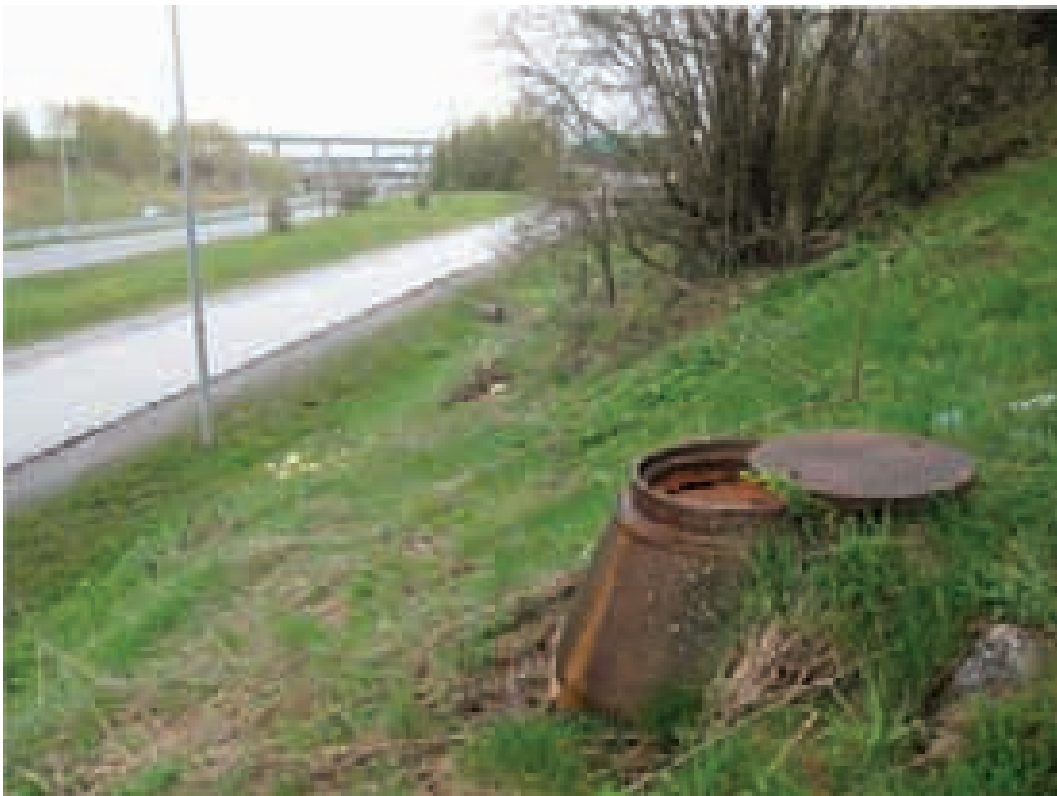
Kuva 8. Suotovesikaivo, josta kaatopaikkavesiä valuu ylivuotona maastoon, sekä penkan läpi suotautuvaa vaahtoista vettä rinteen alareunassa 11.5.2012.
