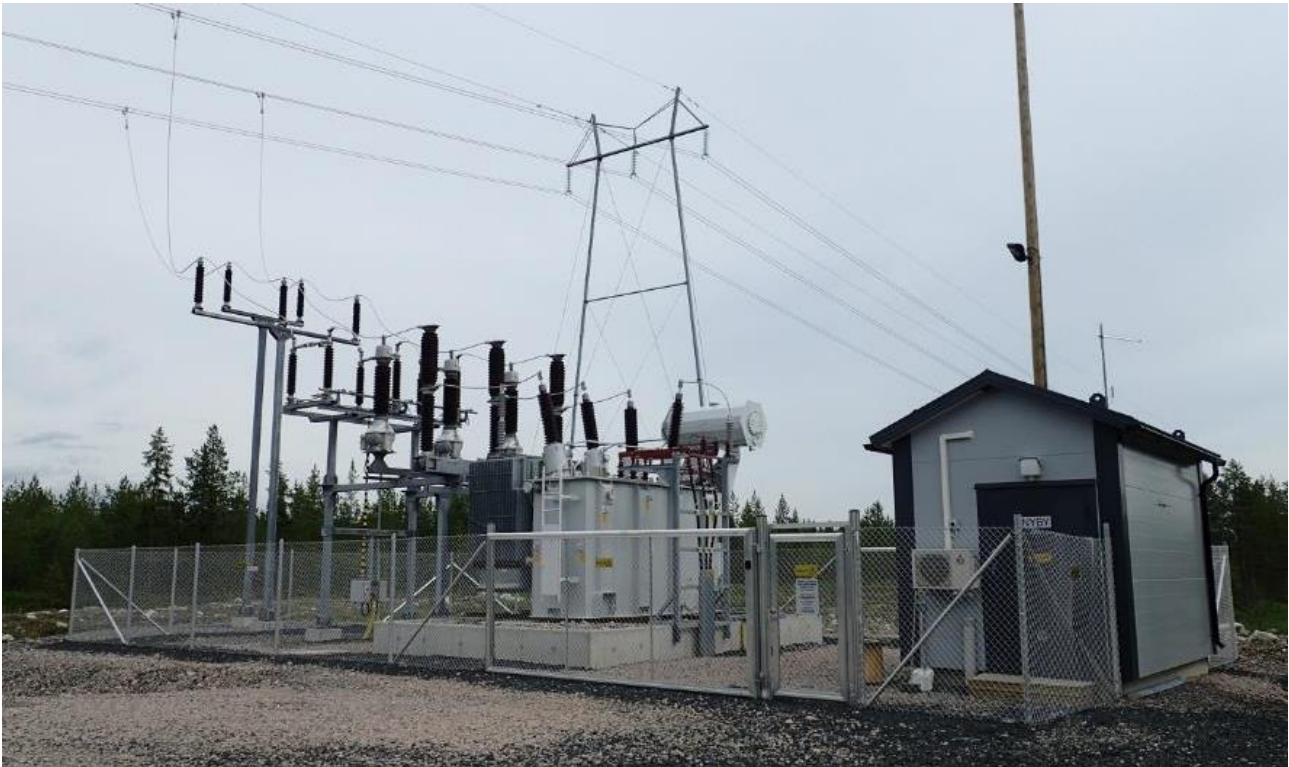
Kuva 12. Esimerkki tuulivoimapuiston muuntoasemasta.
