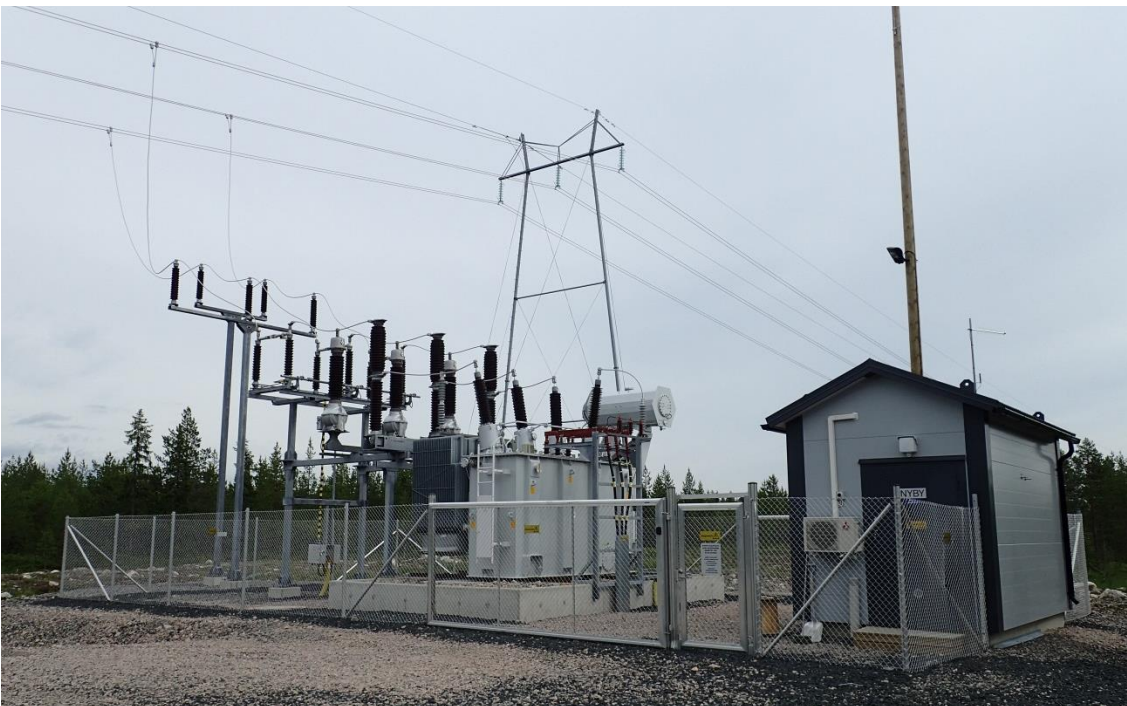
Kuva 5.7. Esimerkki tuulivoimapuiston sähköasemasta (kuva Minna Takalo/FCG).
