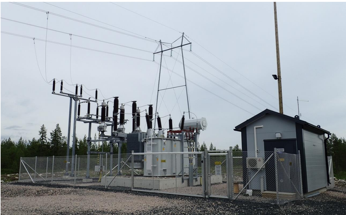
Kuva 4.9. Esimerkki tuulivoimapuiston sähköasemasta (kuva Minna Takalo/FCG).
