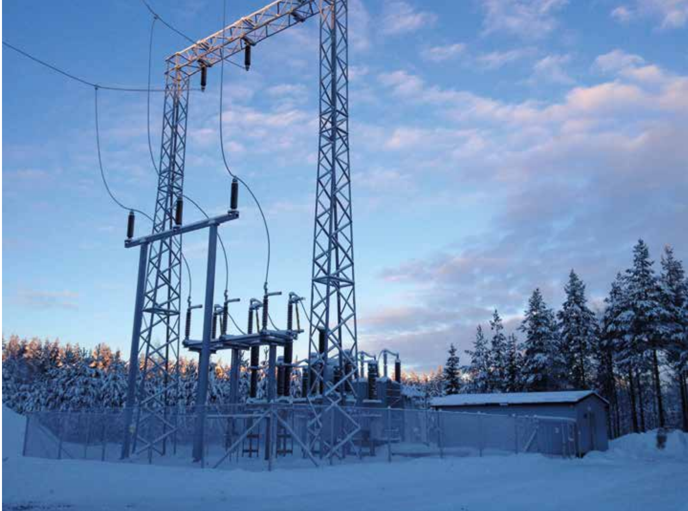
Kuva 3-15. Tuulipuiston sähköasema. Kuva Tuulimuukon asemasta Lappeenrannassa (ABB Oy).
