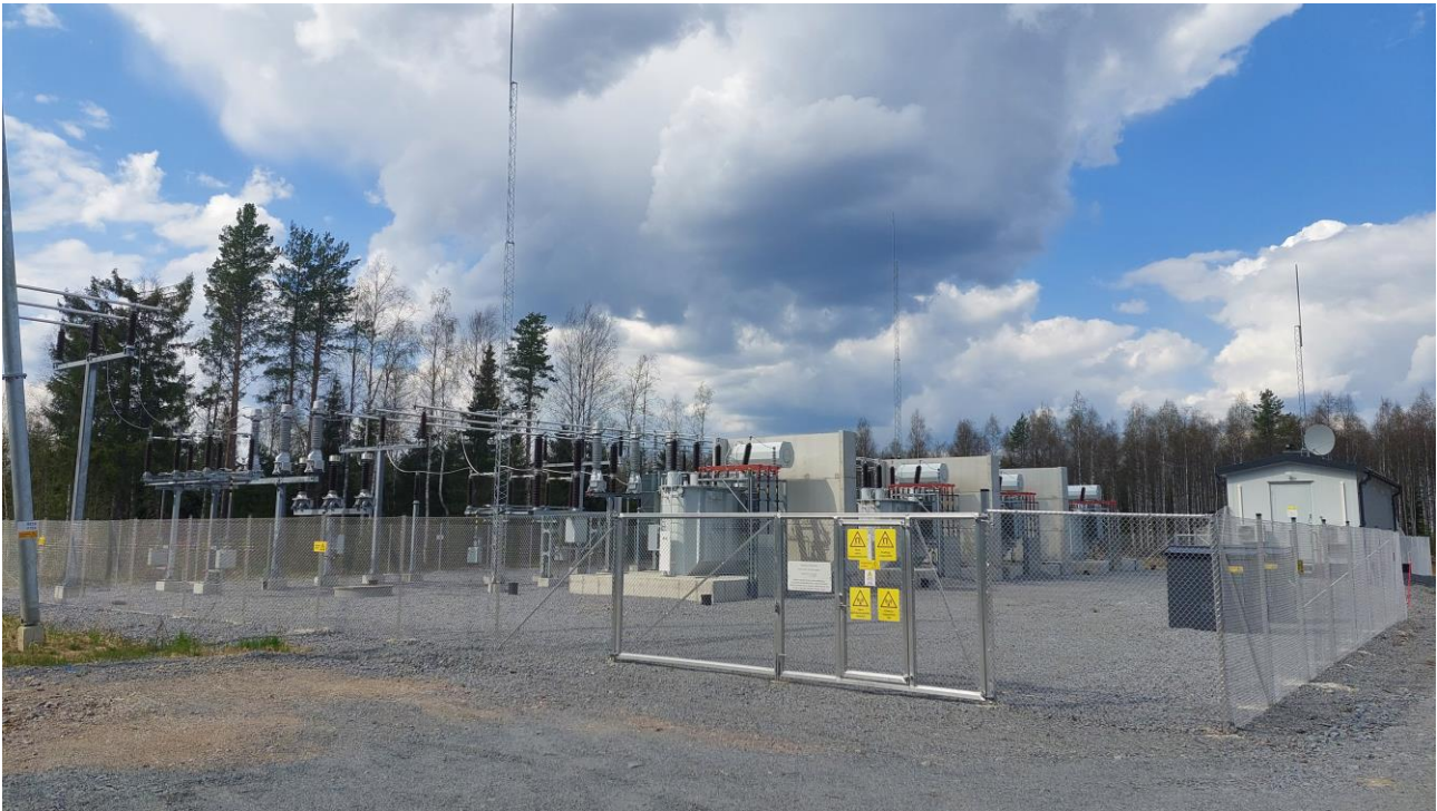
Kuva 21. Esimerkki tuuli- ja aurinkovoimahankkeen sähköasemasta (Välikankaan tuulipuisto, Haapajärvi).
