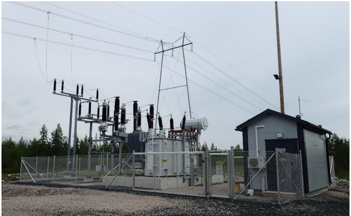
Kuva 15. Esimerkki tuulivoimapuiston sähköasemasta (kuva: FCG).
