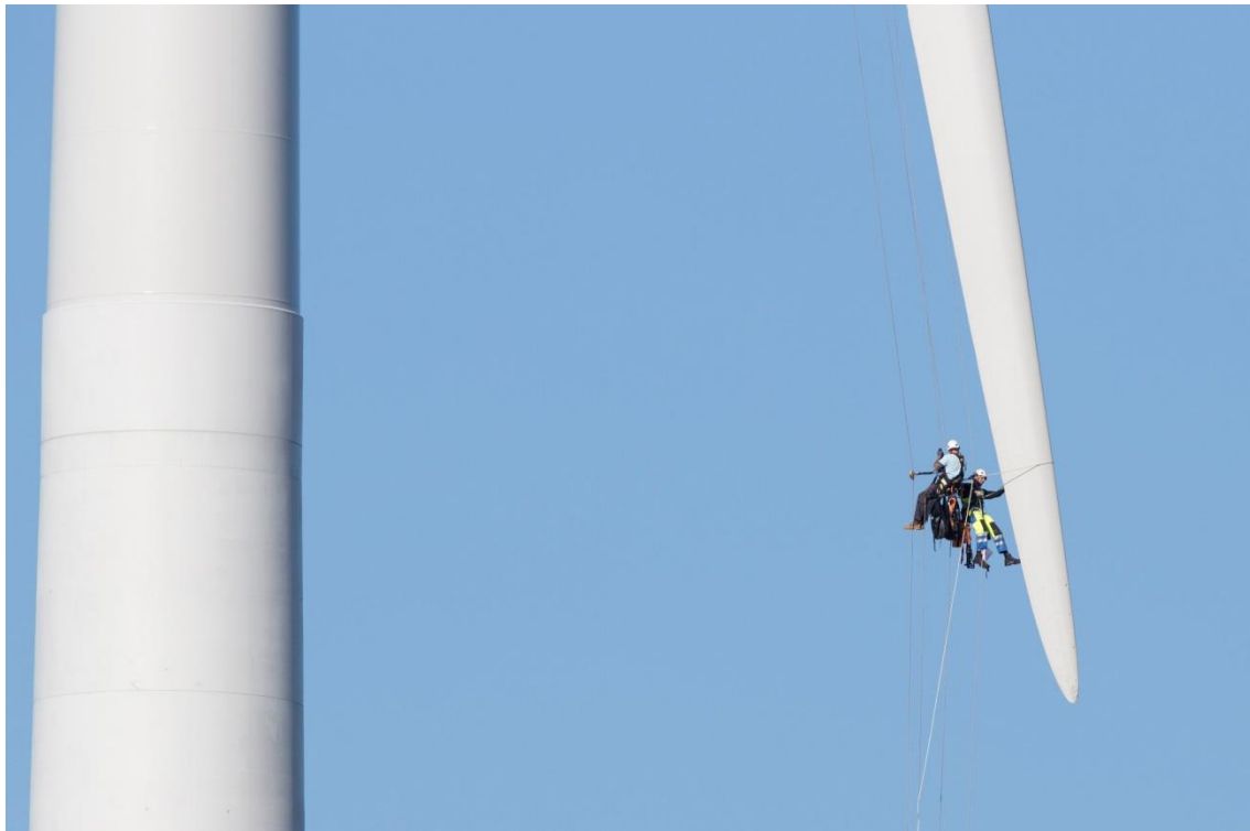
Kuva 22. Tuulivoimalan huoltotoimenpiteitä. (Kuva: FCG)
