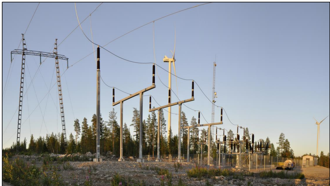
Kuva 5-4. Esimerkkikuva tuulivoimapuiston 20/110 kV sähköasemasta. (Kuva: Leila Väyrynen / FCG).
