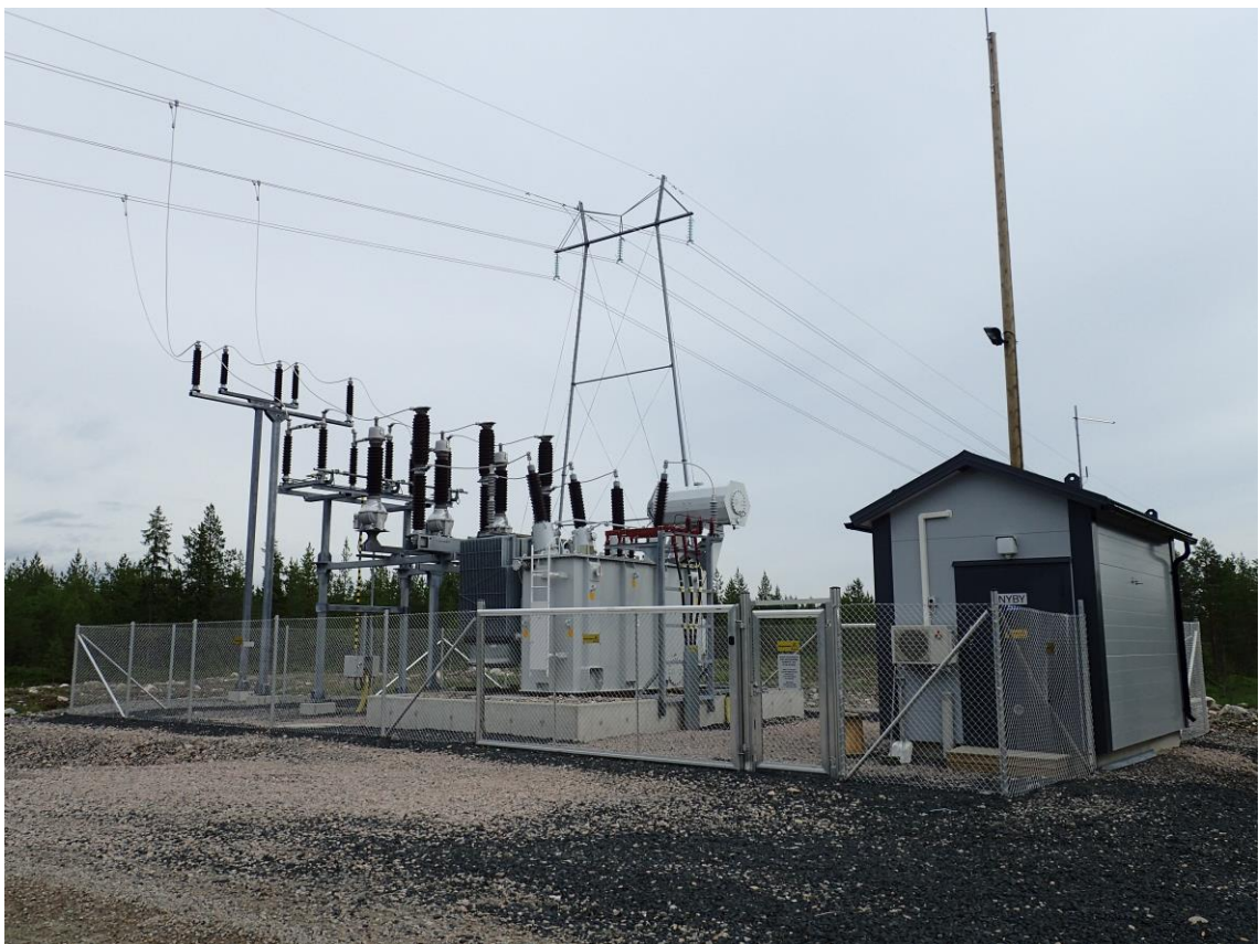
Kuva 5.6. Nybyn tuulivoimapuiston sähköasema (kuva Minna Tuomala/FCG).
