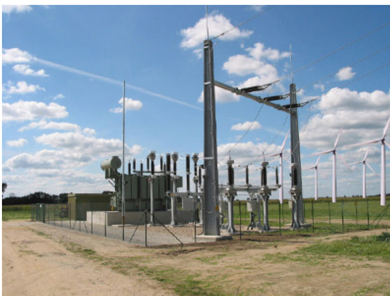
Kuva 4-3. Esimerkki sähköasemasta. (Kuva: Net Resources International 2011, power-technology.com)
