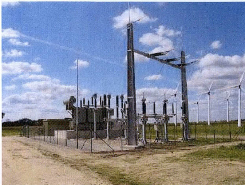
Kuva 4-8. Esimerkki sähköasemasta (kuva: Net Resources International 2011, power-technology.com)
