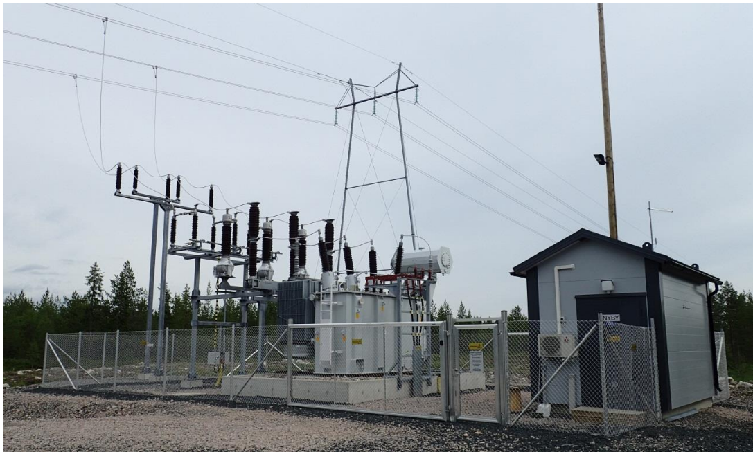
Kuva 5-6. Esimerkki tuulivoimapuiston sähköasemasta (kuva Minna Takalo/FCG).
