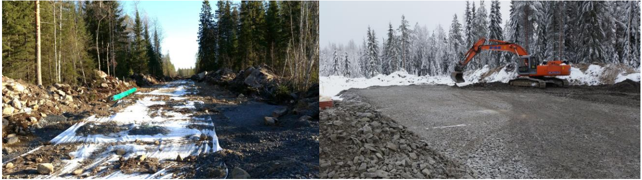
Kuvapari 5.7. Tuulivoimapuiston rakentaminen alkaa huoltoteiden ja pystytysalueiden rakentamisella (kuvat: TM Voima Oy / Pajukoski I työmaa).
