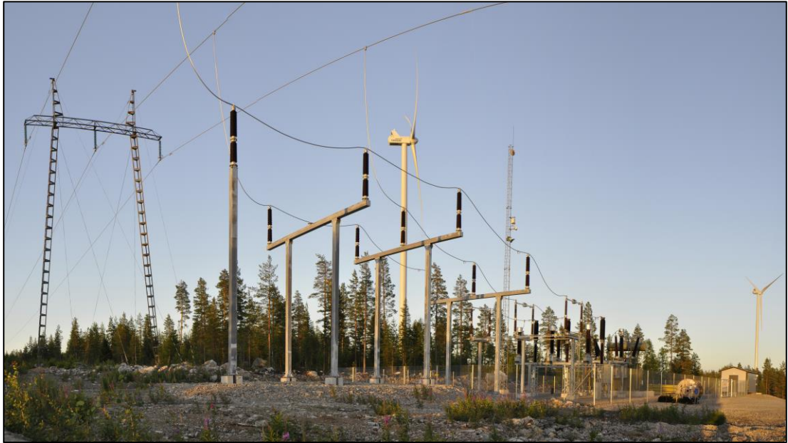
Kuva 5.6. Esimerkkikuva tuulivoimapuiston 20/110 kV sähköasemasta. (Kuva: Leila Väyrynen / FCG).
