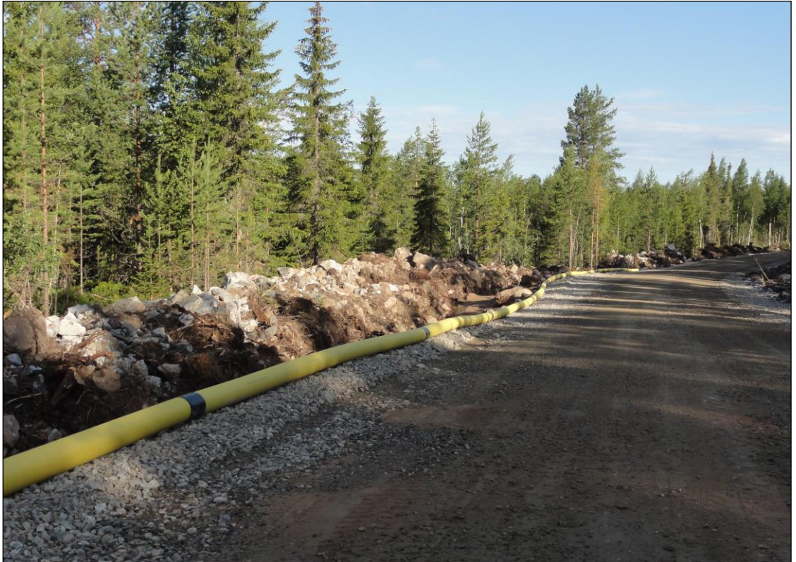
Kuva 5.5. Esimerkki tuulivoimapuiston rakennus- ja huoltotiestä. Teitä käytetään muun muassa betonin, soran ja voimaloiden komponenttien kuljetuksiin sekä tuulivoimapuiston käyttövaiheessa huoltoajoihin. Maakaapeli sijoitetaan ojakaivantoon tien reuna-alueelle (Kuva: Ville Suorsa / FCG).
