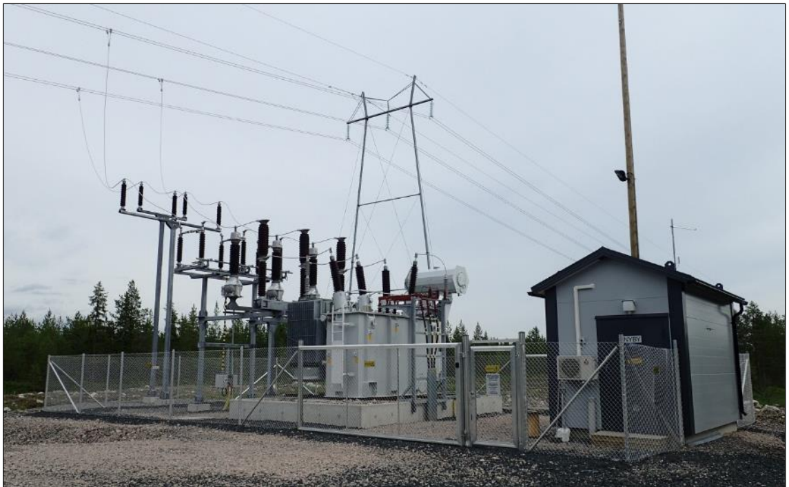
Kuva 5.8. Esimerkki tuulivoimapuiston sähköasemasta. (Kuva: Minna Takalo, FCG)
