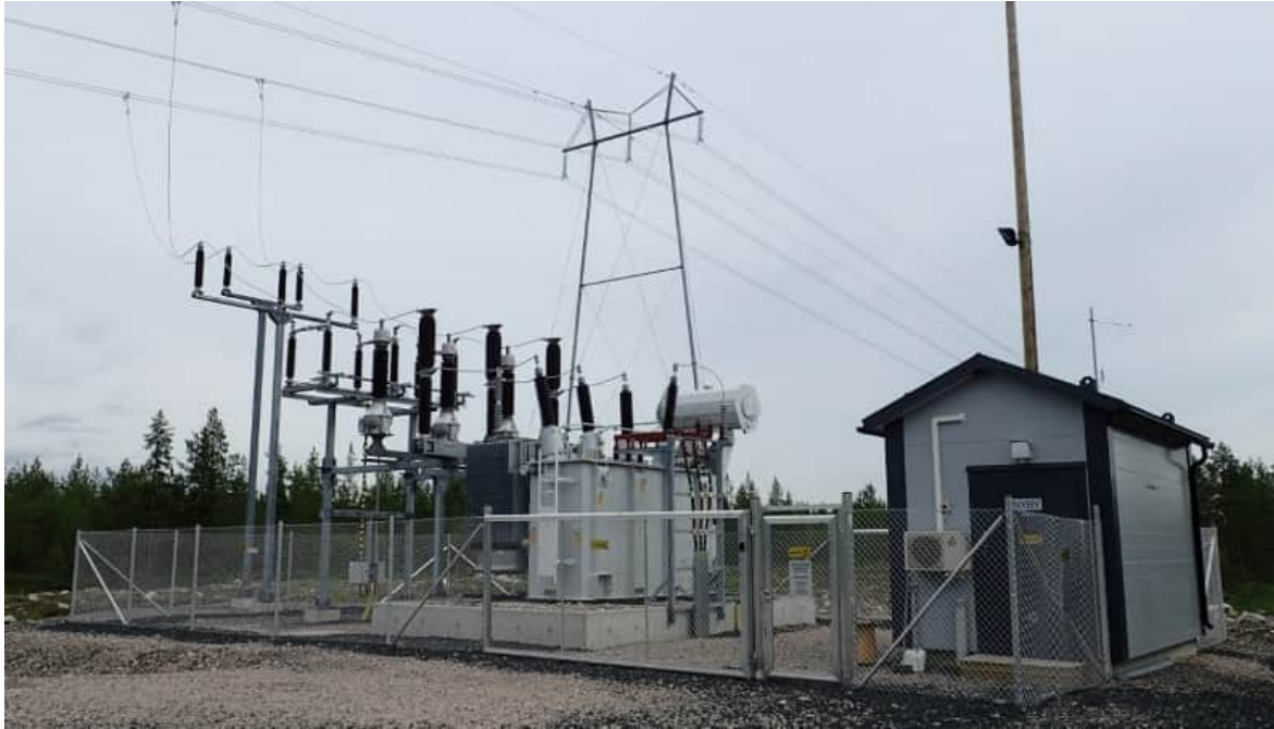
Kuva 4.8 Esimerkki sähköasemasta (FCG Finnish Consulting Group Oy).
