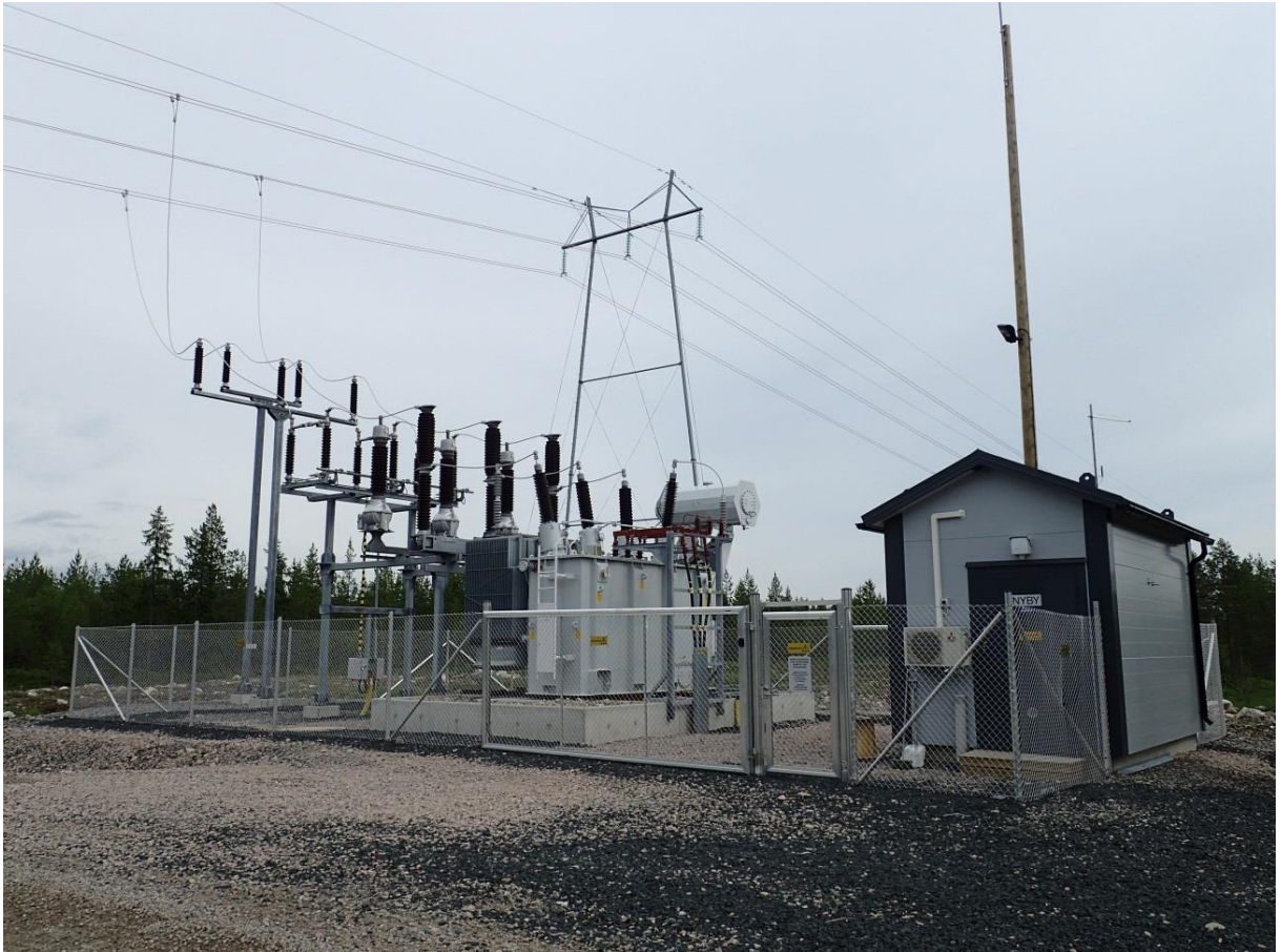
Kuva 19. Esimerkki tuulivoimahankkeen sähköasemasta (Kuva: FCG).
