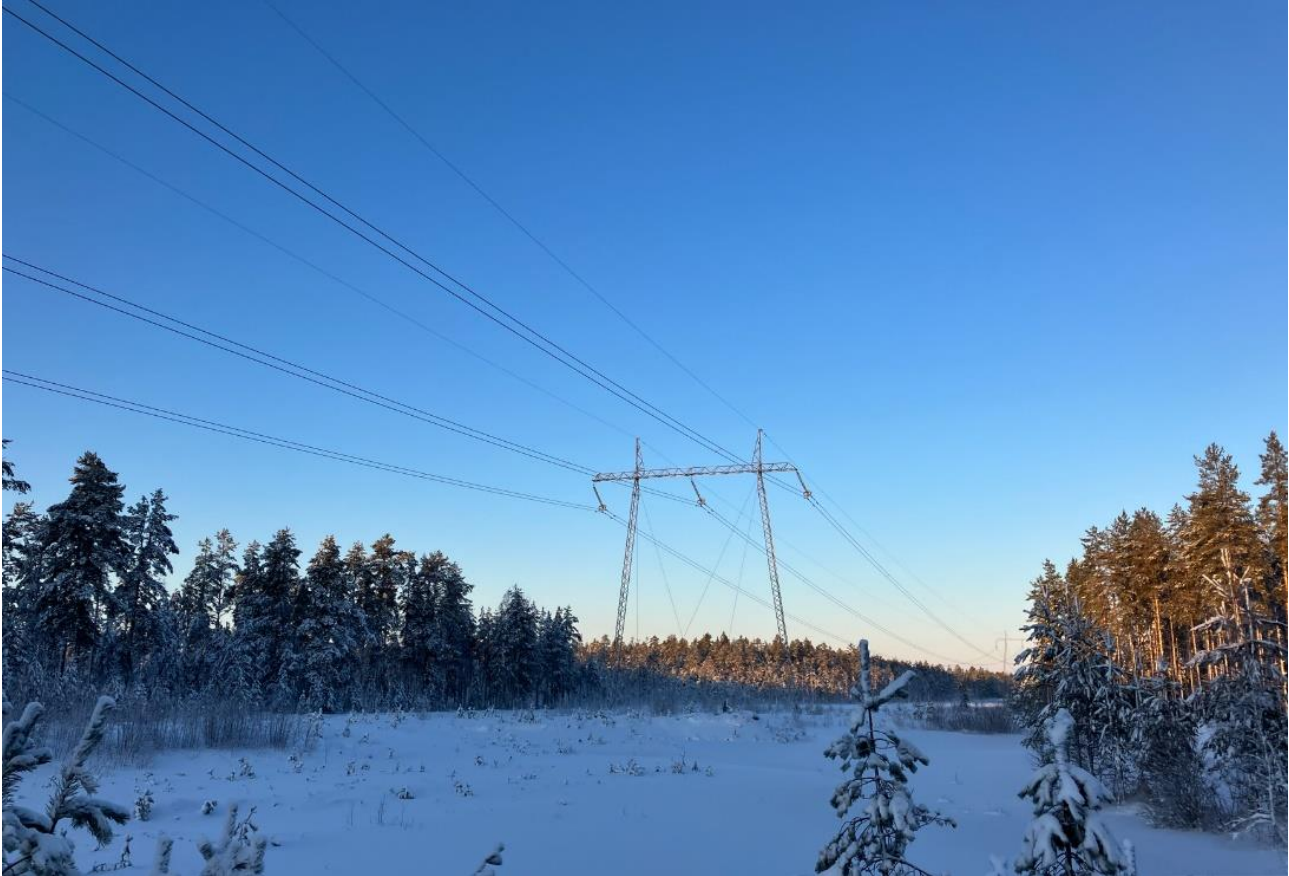
Kuva 141. Nykyinen 400 kV voimajohtolinja Rynkäharjuntien varrella.
