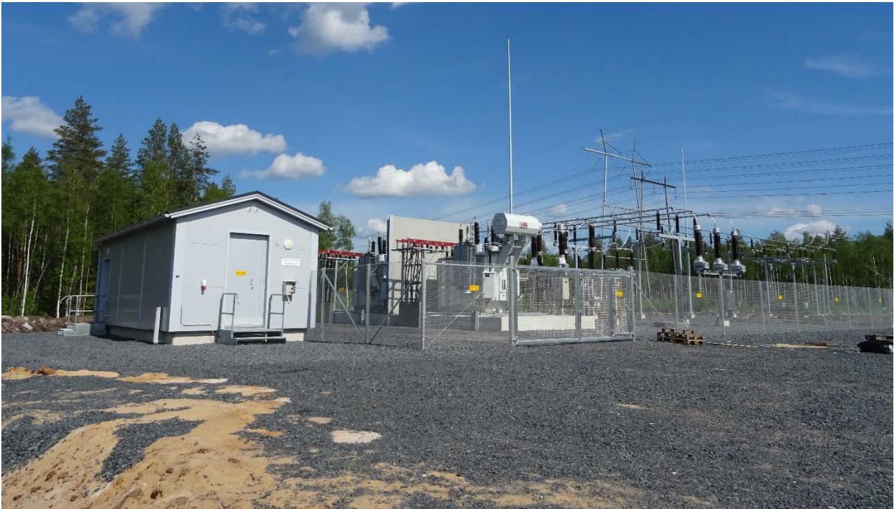
Kuva 23. Esimerkki tuulivoimapuiston sähköasemasta (Oltava, Pyhäjoki).
