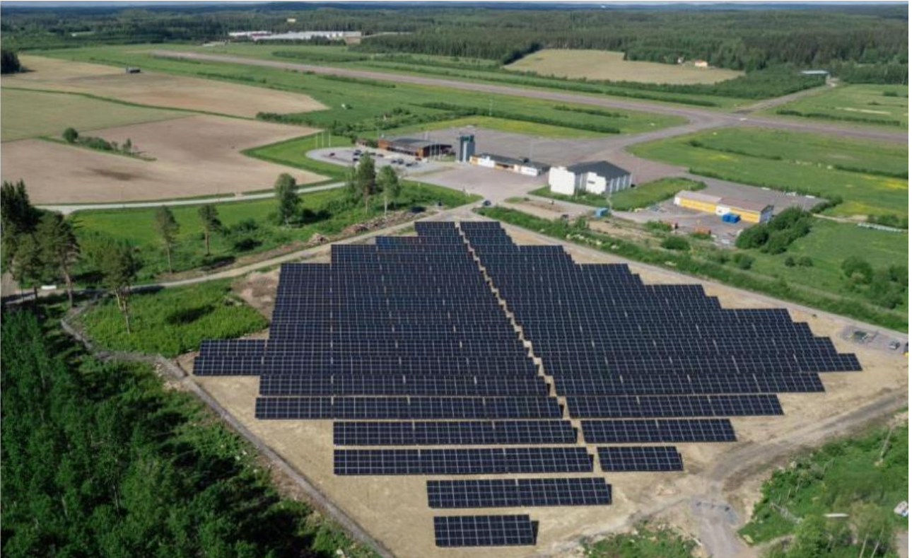
Kuva 15. Esimerkkikuva aurinkovoimalasta. Kuvassa Joroisten lentokentän alueen aurinkovoimapuisto. Alueen pinta-ala on noin 6 ha ja kokonaisteho 5 MWp (Kuva: Ilmatar Energy Oy).
