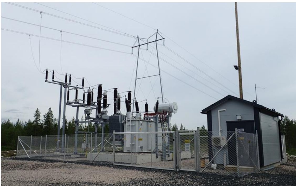
Kuva 79. Esimerkki tuulivoimapuiston sähköasemasta (kuva Minna Takalo/FCG).
