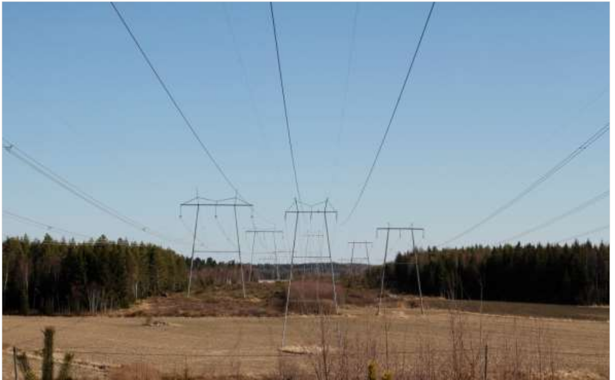
Kuva 11.2. Hankealueen eteläosan voimajohtoalue. Kuva: Pertti Malinen / FCG
