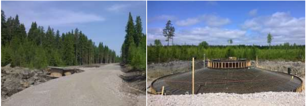
Kuva 11.28. Esimerkki tuulivoimaloiden rakentamisesta. Oikeassa kuvassa perustuksen betonivalu ja vasemmalla voimaloiden kuljetustie. Valokuvat on otettu Närpiön Svalskullan viiden voimalan tuulivoimapuiston työmaalta.
