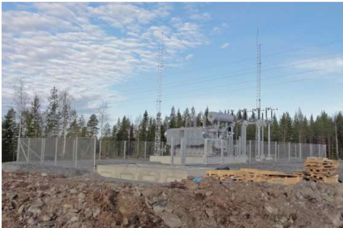
Kuva 5.9. Esimerkkikuva sähköasemasta. Kuva: Ville Suorsa / FCG
