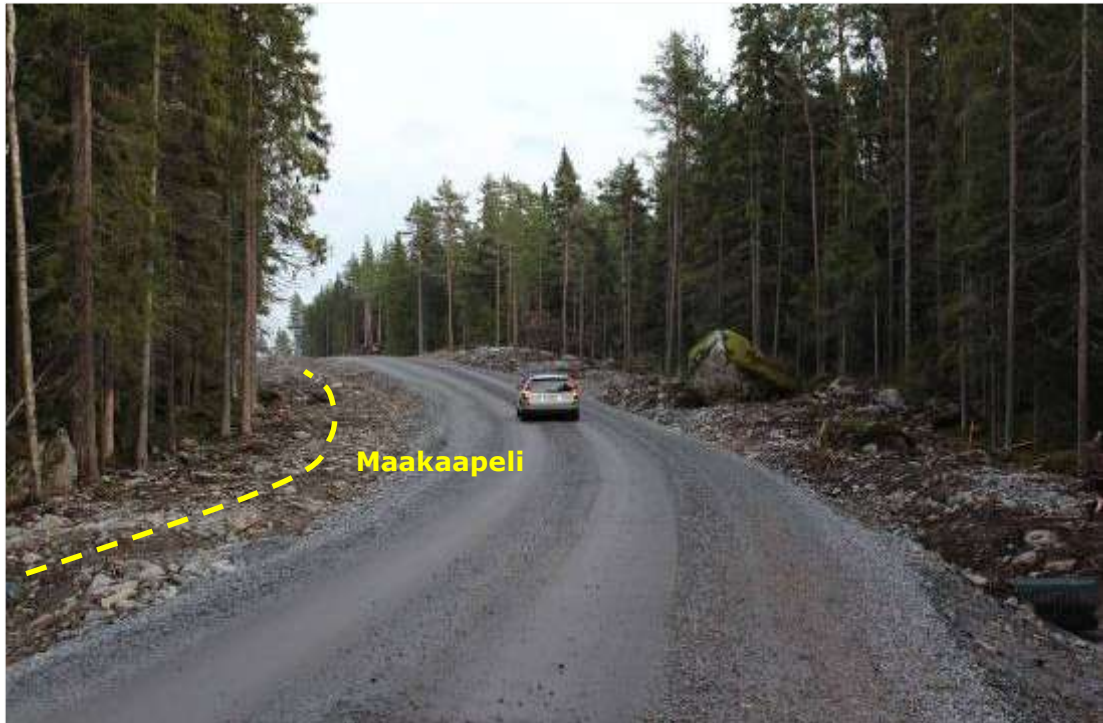
Kuva 5.5. Esimerkki tuulivoimapuiston rakennus- ja huoltotiestä. Maakaapeli on asennettu tien vasemmalle puolelle. Kuva: Hans Vadbäck / FCG
