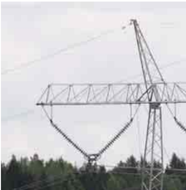
Kuva 153. Voimajohtopylvään eristimiä, joissa koronapurkauksia voi esiintyä.
