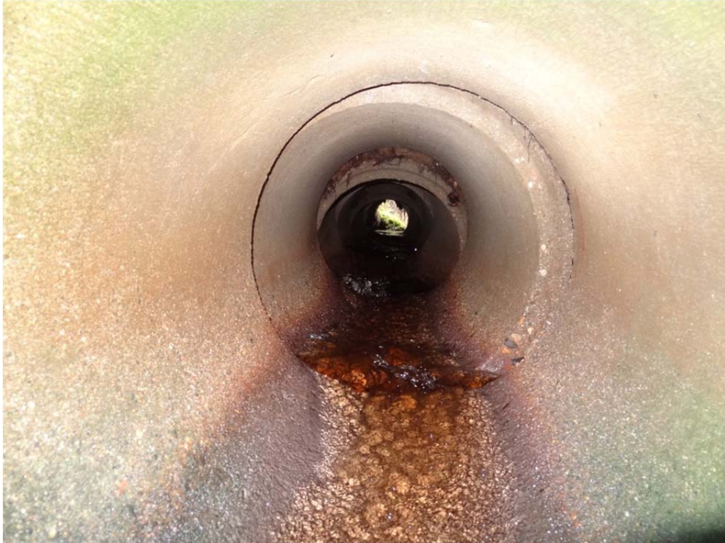
Kuva 6. Voimatien alittava rumpu (Hukkapuro). Rummun betonirenkaat ovat siirtyneet.
