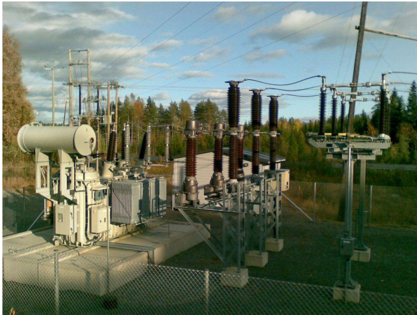
Kuva 4-7. Esimerkki tuulivoimahankkeen 20/110 kV sähköasemasta. (Kuva: Pöyry)
