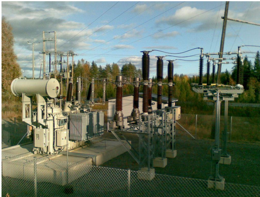
Kuva 4-7. Esimerkki tuulivoimahankkeen 20/110 kV sähköasemasta. (Kuva: Pöyry)
