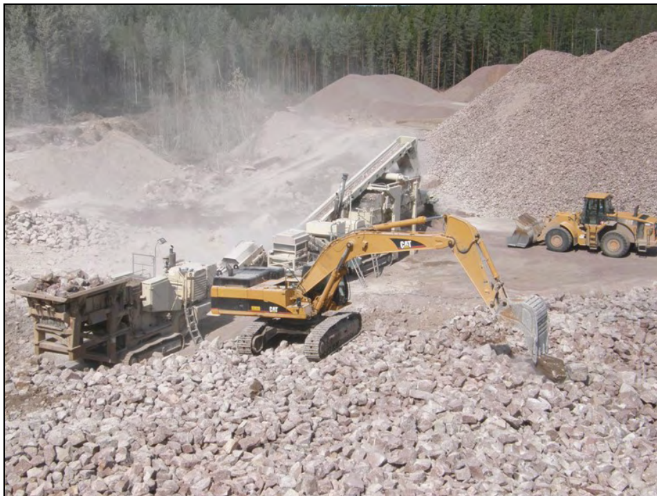
Kuva 3.7. Kolmevaiheinen kivenmurskauslaitos, etualalla laitosta syöttävä kaivinkone
