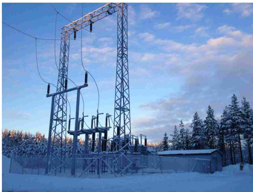
Kuva 2. Tuulipuiston sähköasema. Kuva Tuulimuukon asemasta Lappeenrannassa (Abb Oy).
