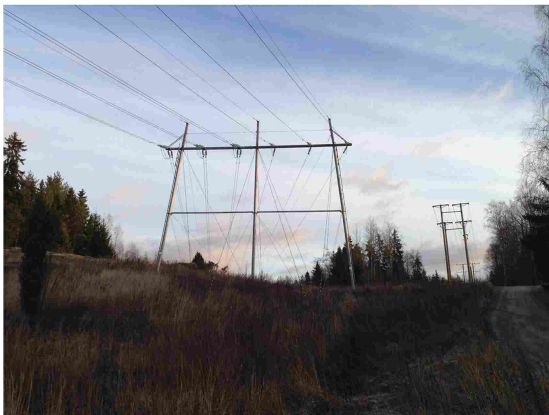
Kuva 3. 110 kV:n voimajohto HD-pylväällä (TLT Engineering 2013).
