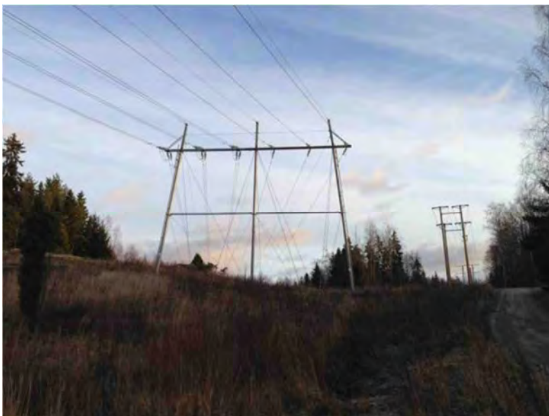
Kuva 8. 110 kV:n voimajohto HD-pylväällä (TLT Engineering 2013).
