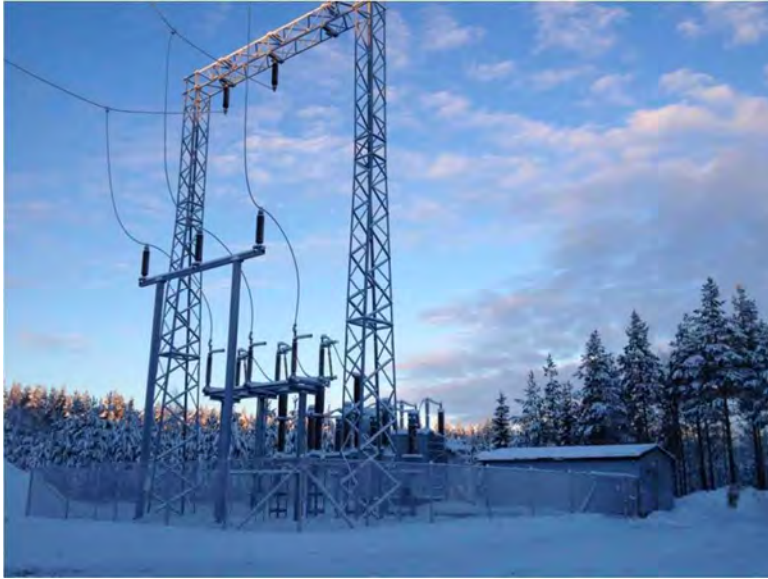
Kuva 7. Tuulipuiston sähköasema. Kuva Tuulimuukon asemasta Lappeenrannassa (Abb Oy).
