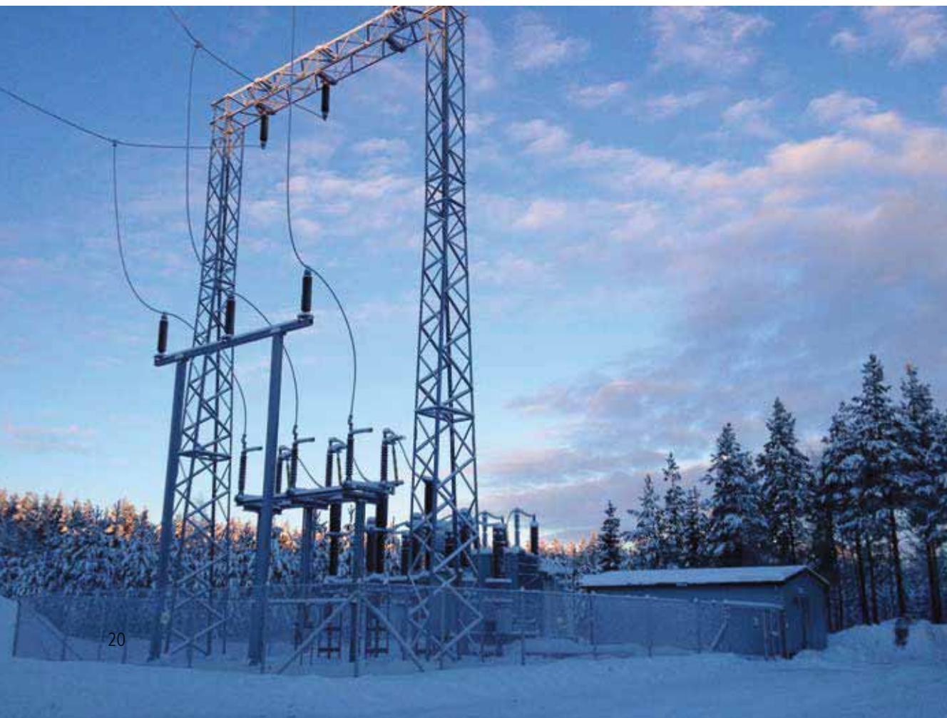
Figur 3-13. En vindkraftsparks elstation. Foto från Tuulimuukkos station i Villmanstrand (ABB Oy).
