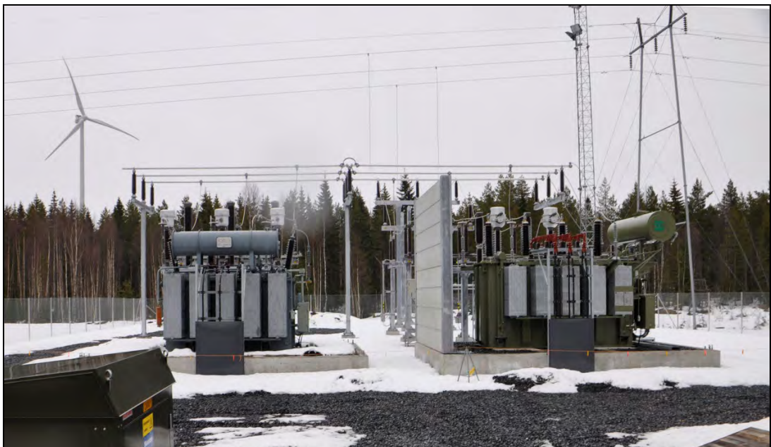
Kuva 5.7. Esimerkki tuulivoimapuiston sähköasemasta. (Kuva: Leila Väyrynen / FCG)
