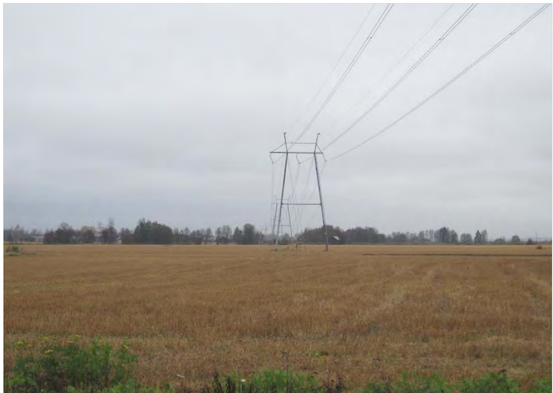
Kuva 5.10. Esimerkki 110 kV ilmajohtosta ja harustetuista portaalipylväistä. (Kuva: Janne Märsylä / FCG)
