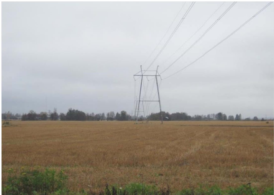
Kuva 5.11. Esimerkki 110 kV ilmajohdosta ja harustetuista portaalipylväistä. (Kuva: Janne Märsylä / FCG)
