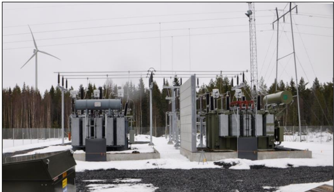
Kuva 5.8. Esimerkki tuulivoimapuiston sähköasemasta. (Kuva: Leila Väyrynen / FCG)
