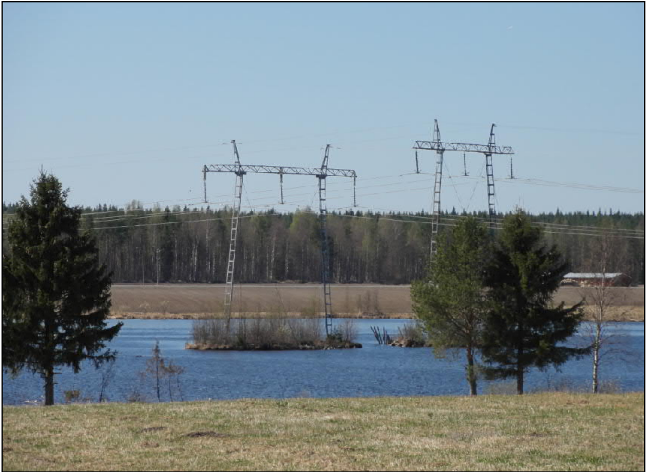
Kuva 13. Tekoluodolle rakennetut nykyiset voimajohtopylväät Haapajärven Kortejärvellä.
