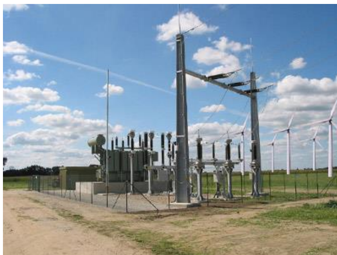
Kuva 4-5. Esimerkki sähköasemasta. (Kuva: Net Resources International 2011, power-technology.com)
