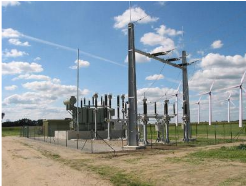
Kuva 4-8. Esimerkki sähköasemasta. (kuva: Net Resources International 2011, power-technology.com)
