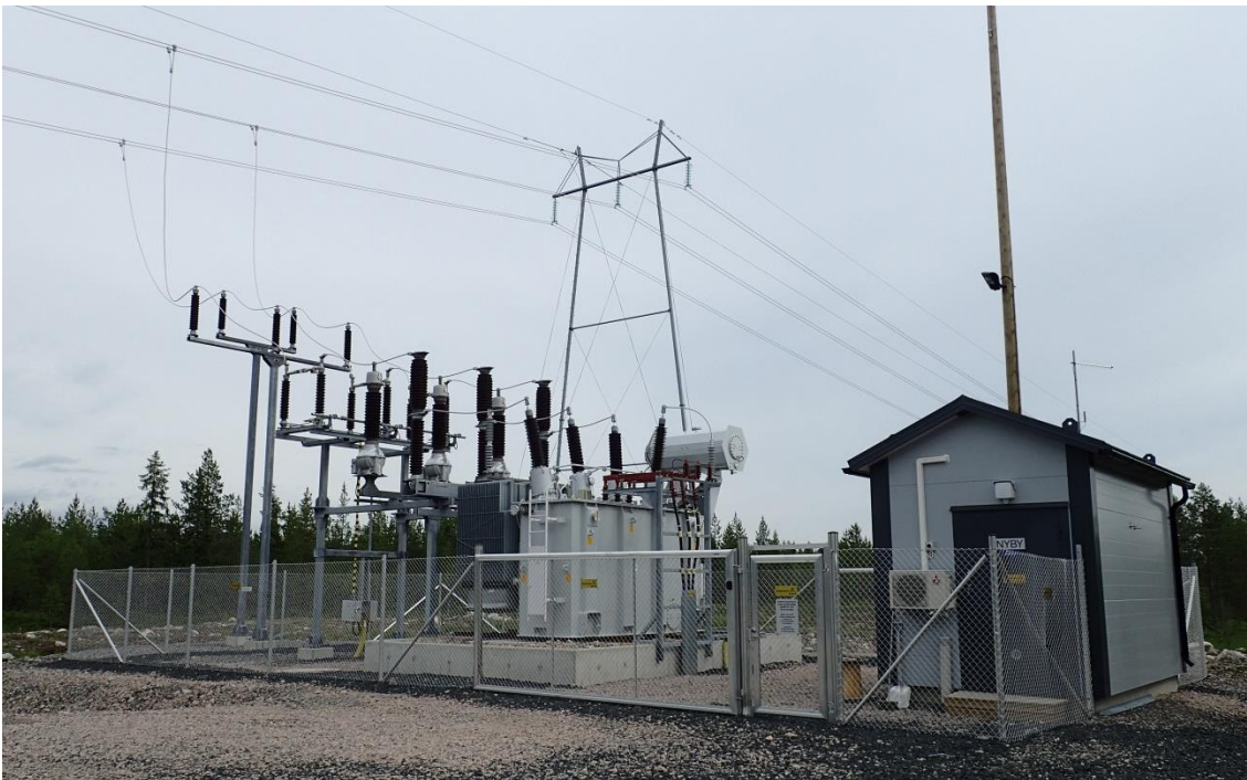
Kuva 5.8. Esimerkki tuulivoimapuiston sähköasemasta (kuva Minna Takalo/FCG).
