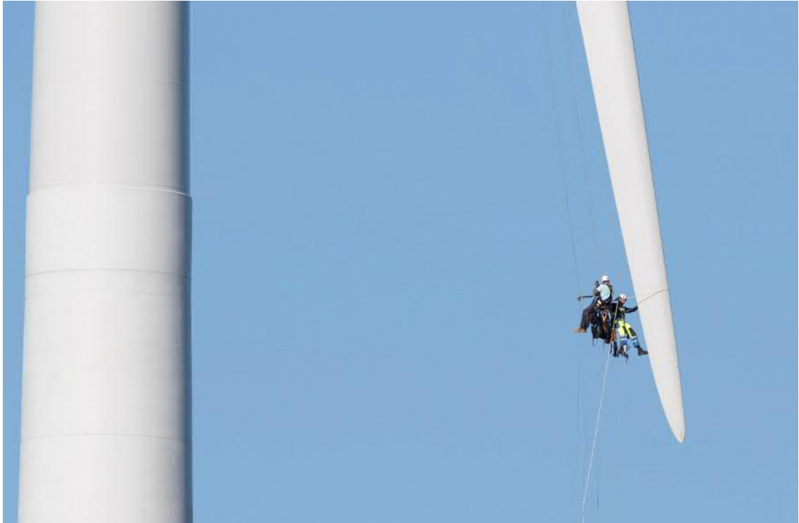
Kuva 4.18. Tuulivoimalan huoltotoimenpiteitä. (Kuva: FCG).
