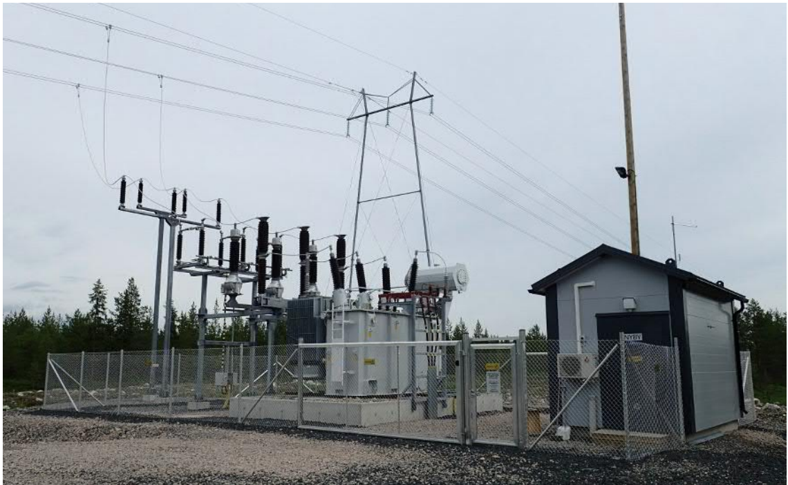
Kuva 4.9. Esimerkki tuulivoimapuiston sähköasemasta (kuva: FCG).
