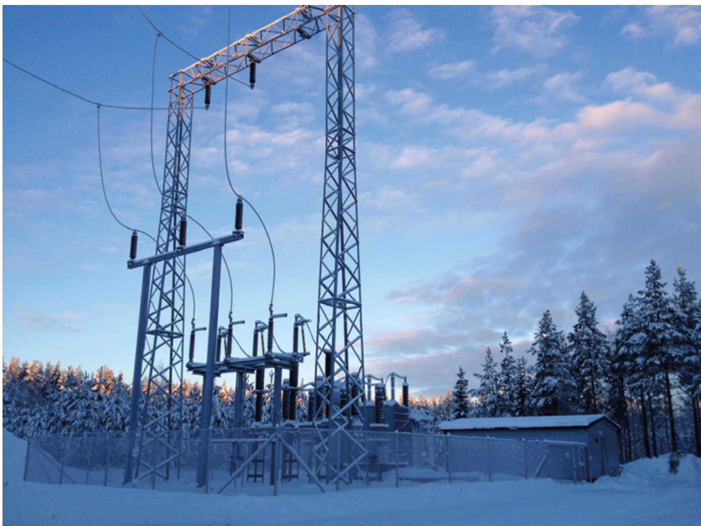
Kuva 3-13. Tuulivoimapuiston sähköasema. Kuva Tuulimuukon asemasta Lappeenrannassa (ABB Oy).
