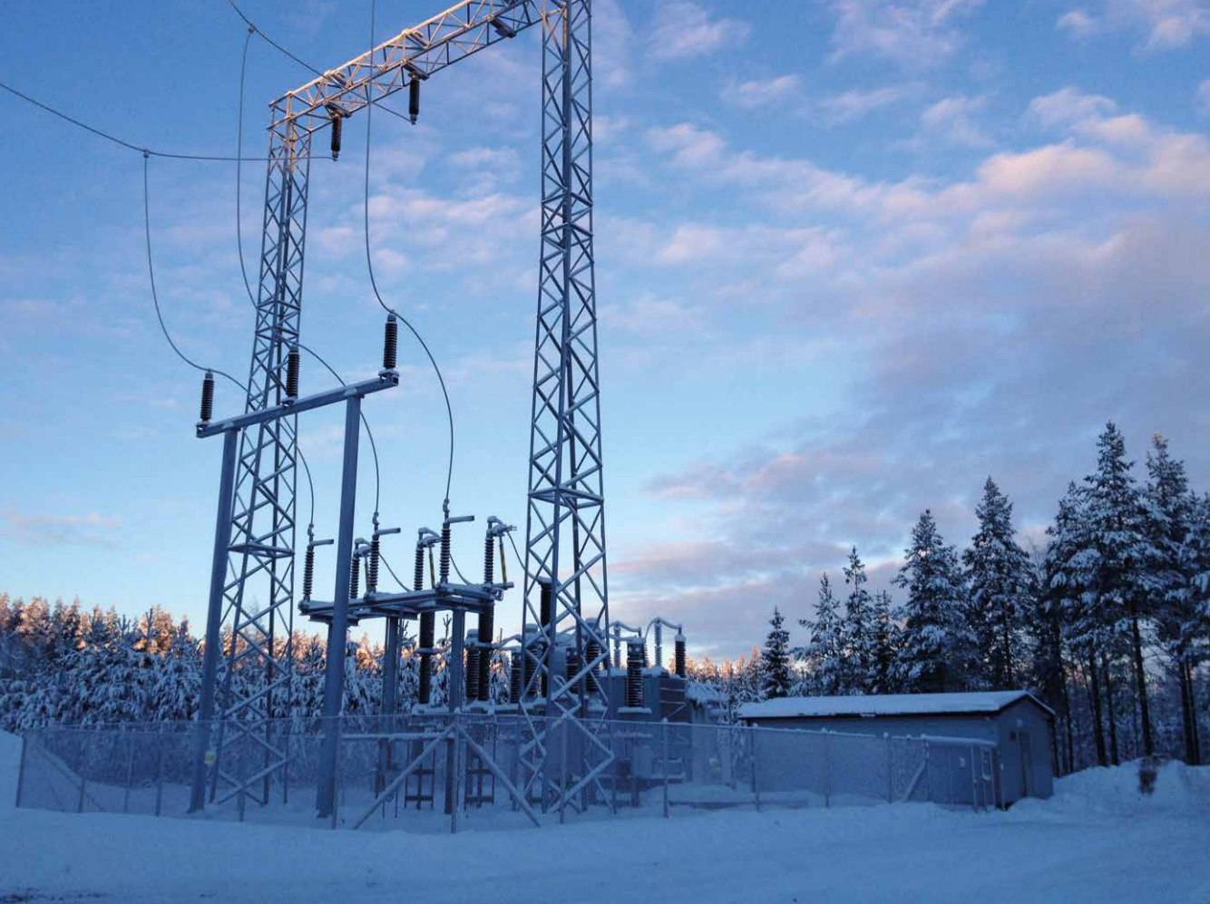
Kuva 4-10. Tuulivoimapuiston sähköseman esimerkkikuva. Kuva Tuulimuukon asemasta Lappeenrannassa (ABB Oy).
