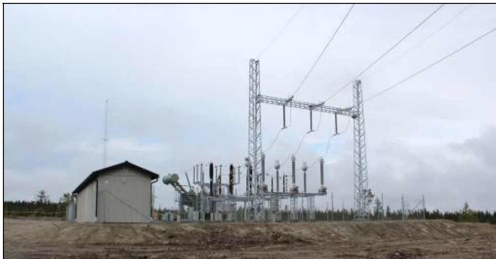
Figur 12. Exempel på en 64 MVA elstation.
