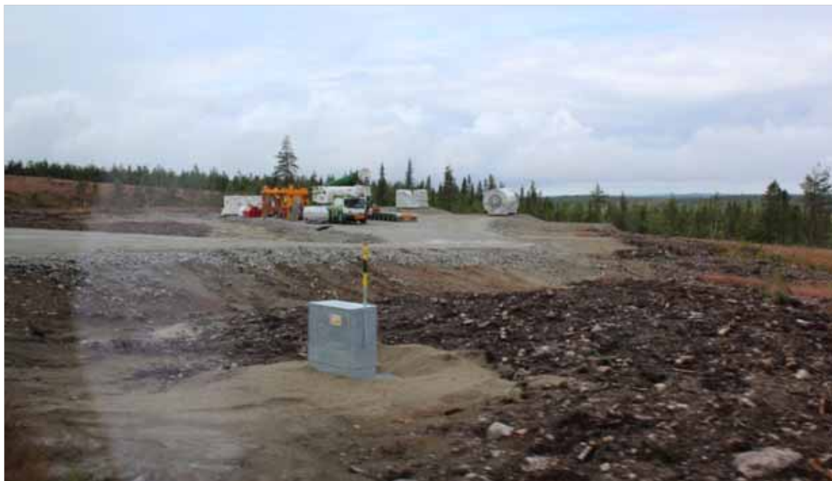
Figur 6.7. Monteringsområde för ett vindkraftverk. På fotot syns bland annat kraftverkets maskinhus och en mindre hjälplyftkran (foto: Hans Vadbäck/FCG).
