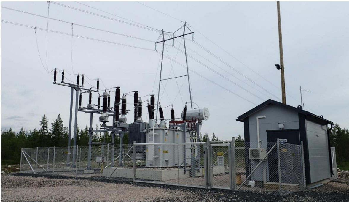
Bild 5.7 Exempel på elstation (FCG).
