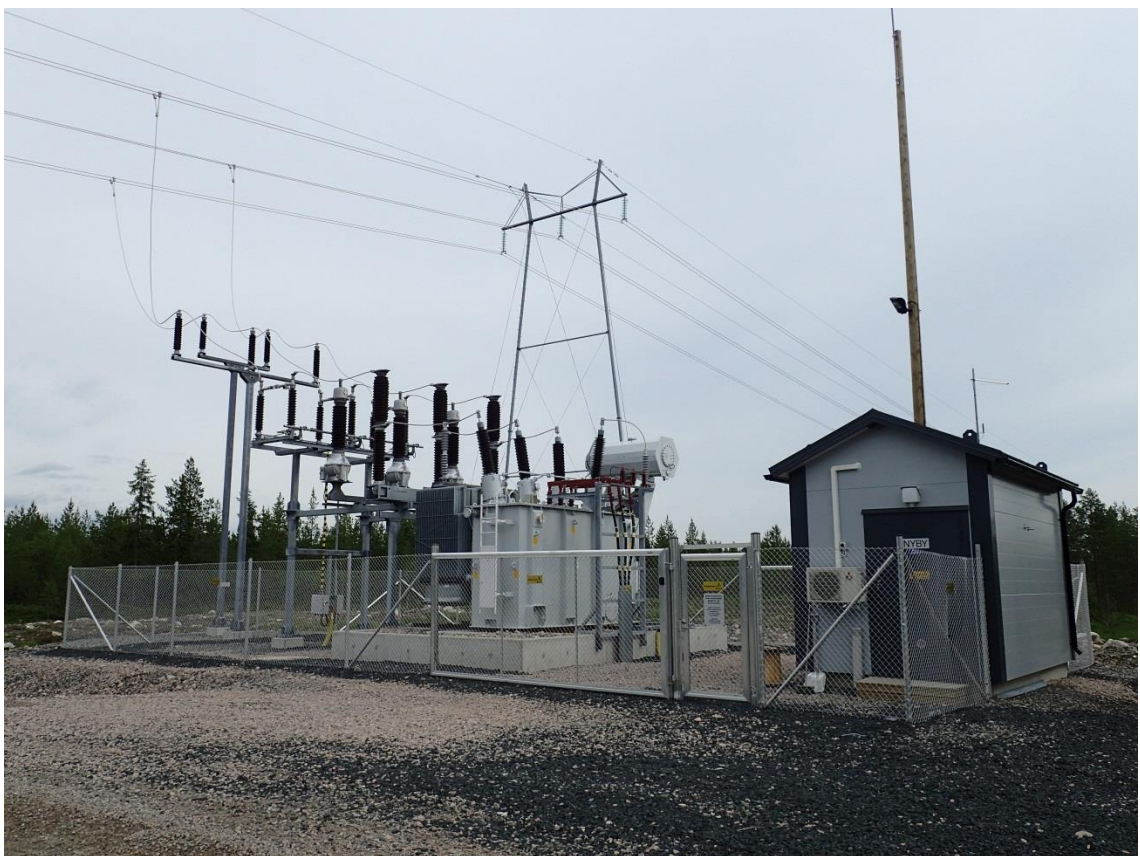
Kuva 5.7. Esimerkki tuulivoimapuiston sähköasemasta (kuva Minna Takalo/FCG).
