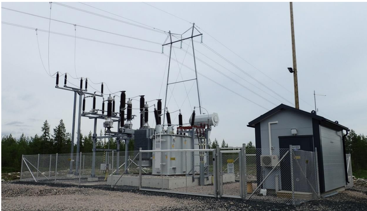
Kuva 5-7 Esimerkki tuulivoimahankkeen sähköasemasta (FCG).
