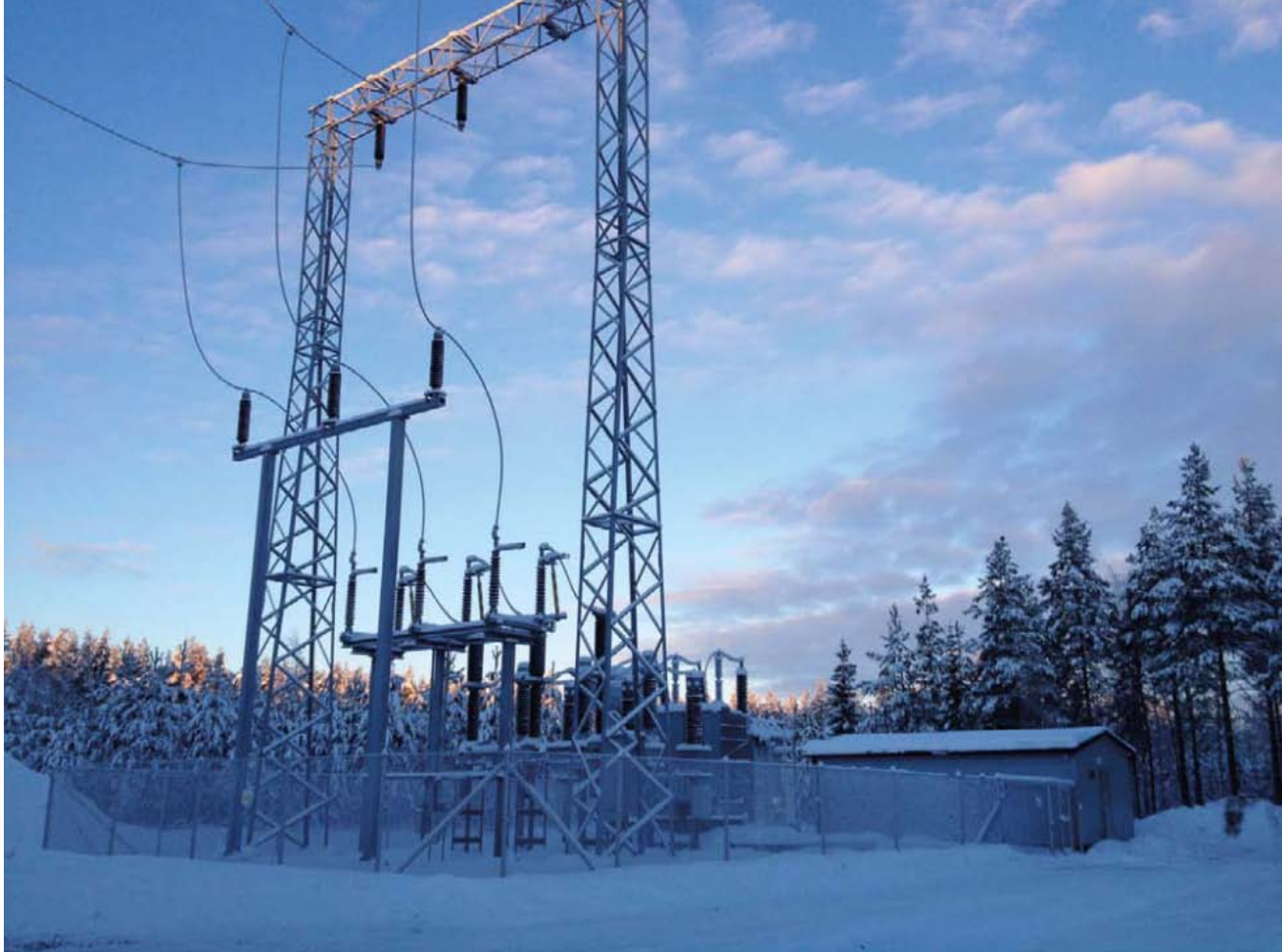
Kuva 3-16. Tuulipuiston sähköasema. Kuva Tuulimuukon asemasta Lappeenrannassa (Abb Oy).
