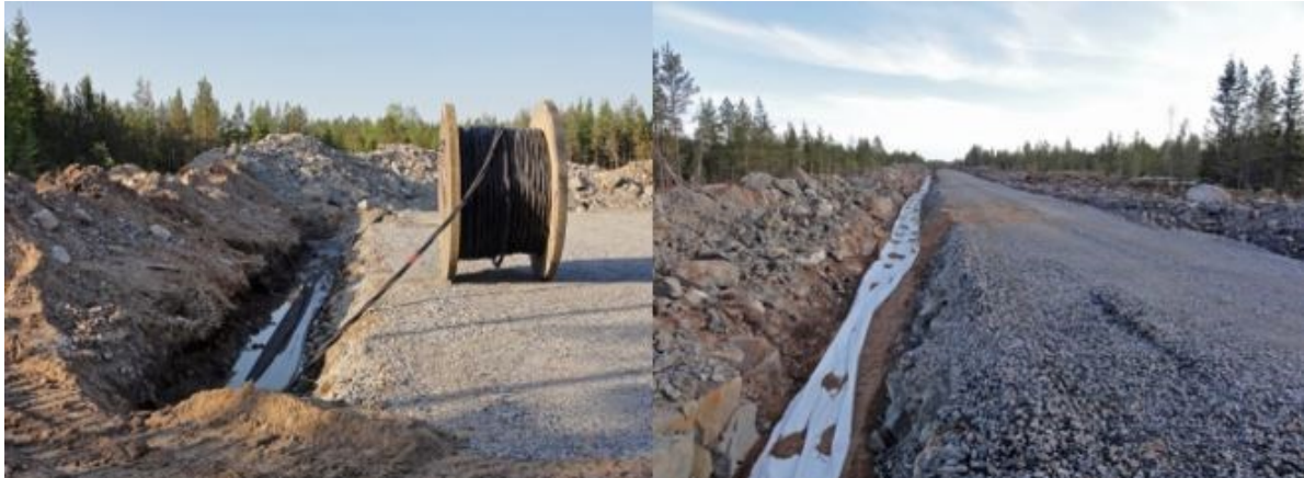
Kuva 5-11 Maakaapelit upotetaan huoltoteiden yhteyteen (FCG Finnish Consulting Group Oy).
