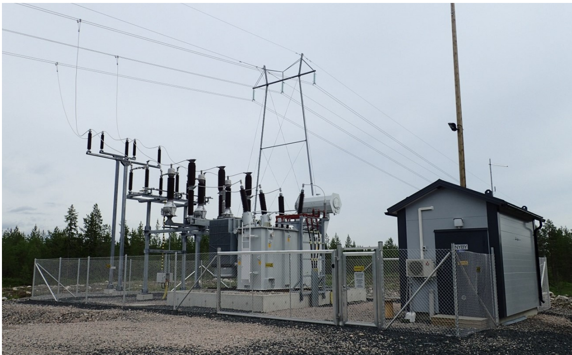
Kuva 5-7 Esimerkki tuulivoimapuiston sähköasemasta (FCG Finnish Consulting Group Oy).
