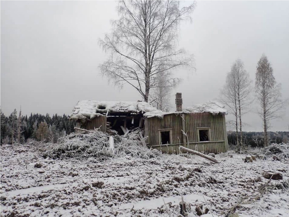
Kuva 44. Sortunut rakennus Sahinmäen korkeimmalla kohdalla, hakkuuaukealla. Etelään.
