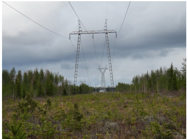
Kuva 18. Linjan pohjoispää, taustalla Alajärven sähköasema, kuvattu pohjoiseen.
