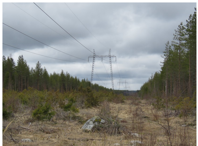
Kuva 12. Voimalinja Uudenhaudankankaan kohdalla kuvattu luoteeseen.
