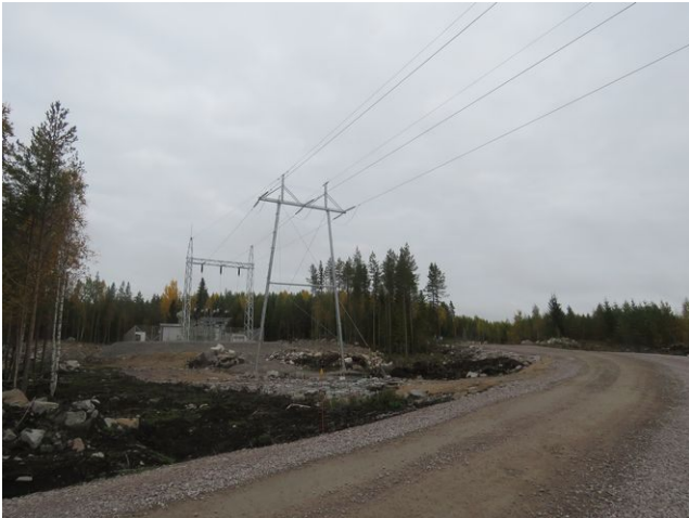
Kuva 19. Huhtasalunkankaan uusi sähköasema.
