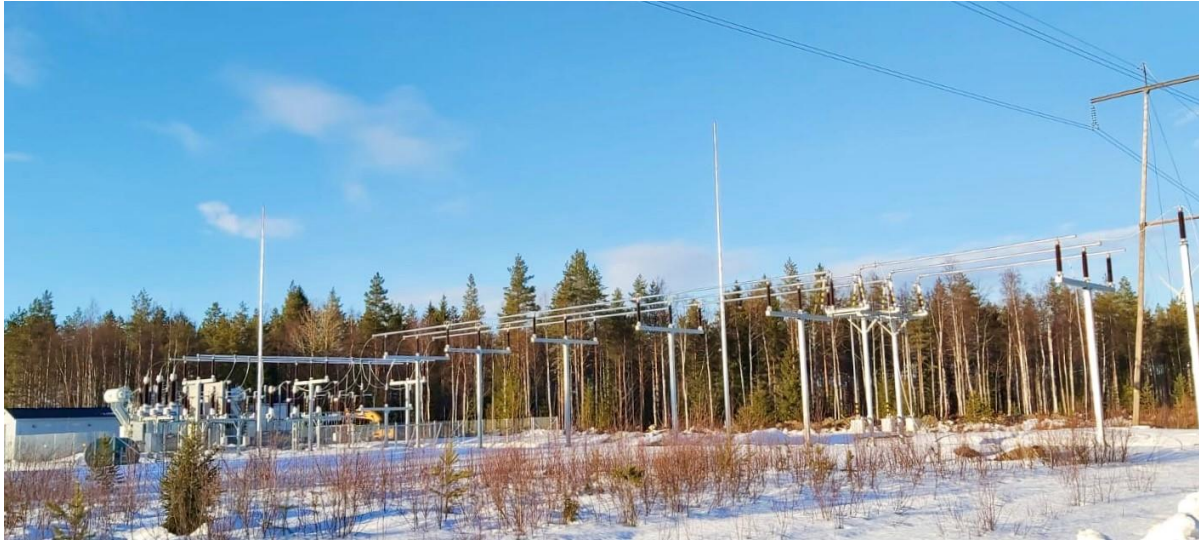
Kuva 2-10. Tuulivoimapuiston sähköasema (© ELTEL Networks Oy).
